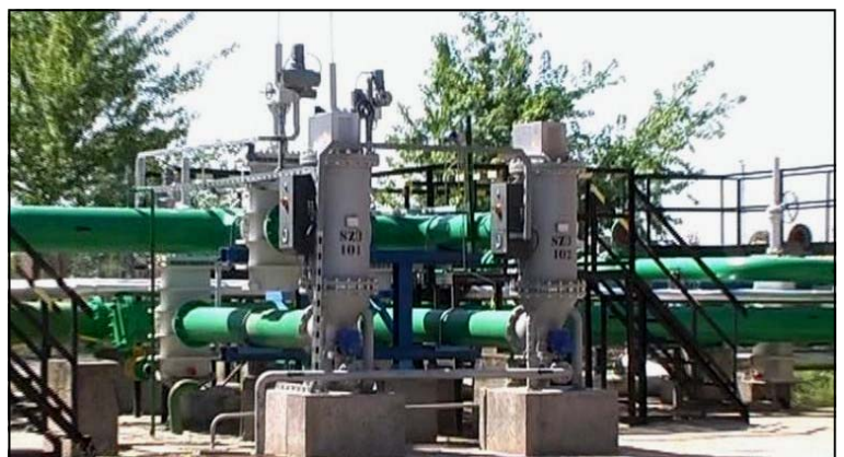
A vízbesajtolás felszíni technológiai berendezései Algyőn
